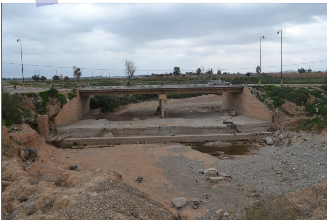
Photo 3 : Affouillement à l'aval du pont de Hay Mohammadi (Lastah)
